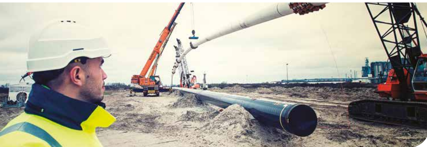
Chantier des Hauts de France II, franchissement du Canal des Dunes (Dunkerque) © GRTgaz, Alexandre Sargos
