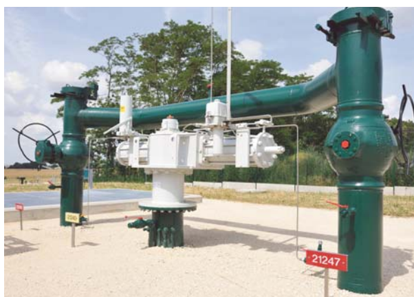
Poste de sectionnement
