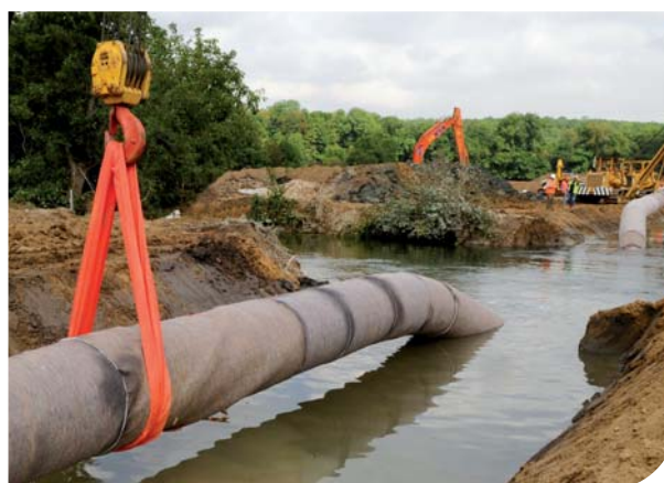
Tronçon de canalisation traversant un cours d'eau
