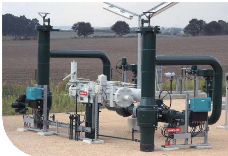
Poste de sectionnement
